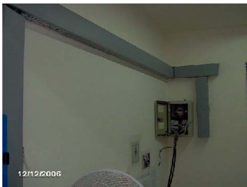
Foto N° 5 – Esta es la oficina del asesor para discapacitados del CGP 2, mide 1,80 x 3,60 m., no tiene ventanas por lo que la ventilación es mala y se siente olor a humedad. En la foto se puede apreciar un tablero de electricidad seccional con cuatro llaves térmicas y un disyuntor eléctrico que presenta cables expuestos y encintados que salen peligrosamente por el frente de la caja .
