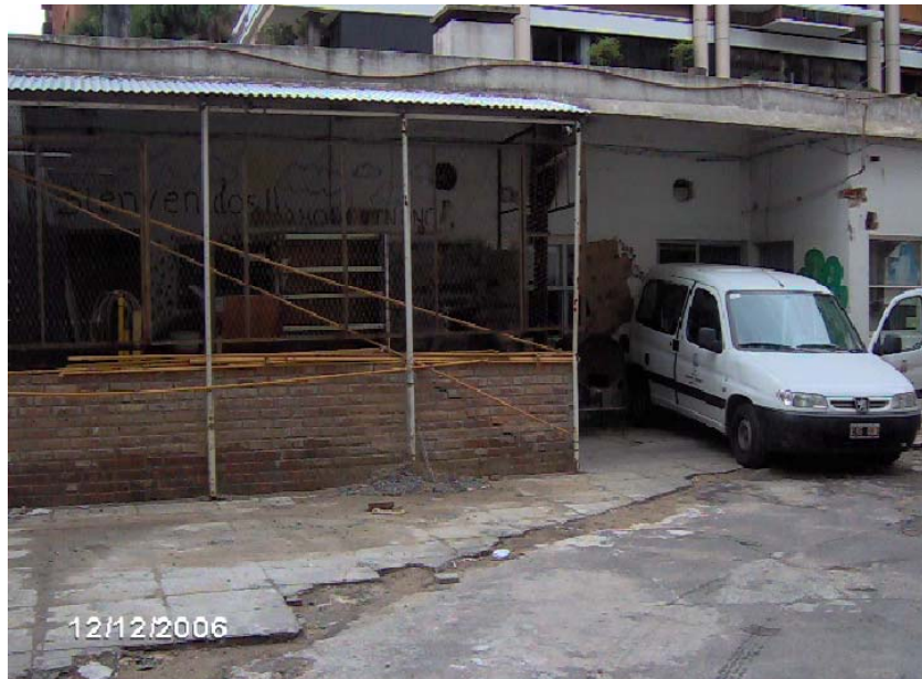
Foto N° 16 – En la presente vista se puede apreciar el mismo sector de la foto anterior donde se pueden observar cables expuestos. El hecho de estar en obra no justifica este desorden en la instalación eléctrica pues el edificio esta habitado.
