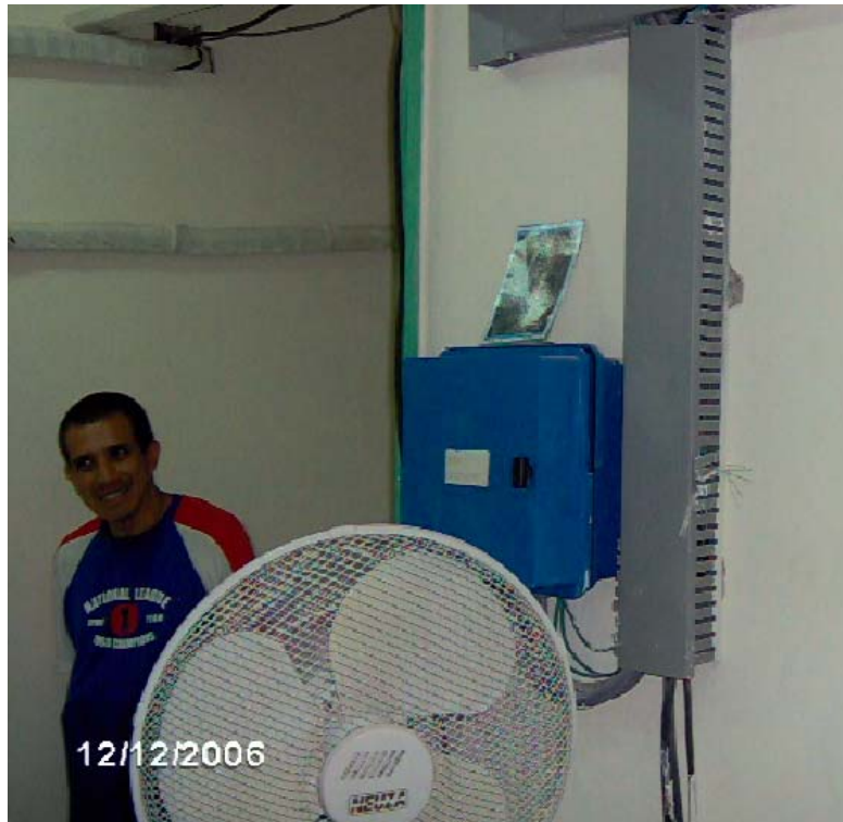
Foto N° 6 – En la presente vista se puede apreciar un tablero de AA con cables expuestos en la salida del mismo y en el cielorraso alimentando un artefacto de iluminación .
