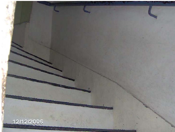
Foto N° 10 – Escalera por la que se accede desde la PB al entrepiso, la misma no presenta condiciones para que accedan discapacitados al piso superior, es angosta y compensada.
