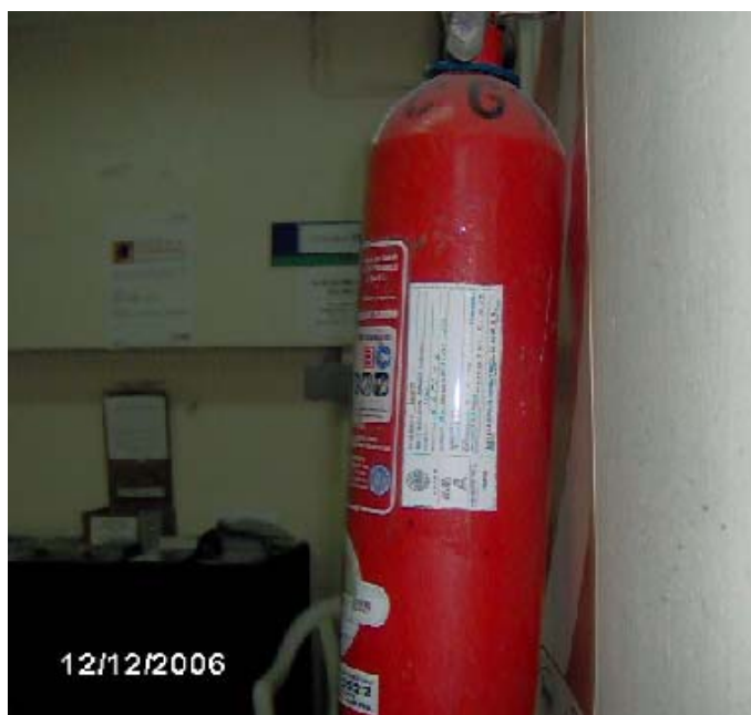
Foto N° 4 – Matafuego tipo, hay varios y están colocados en sus bases, tienen fecha de vencimiento 24/08/07, están colocados en lugares estratégicos y cumplen con uno cada 200 m2 como marca el CE.
