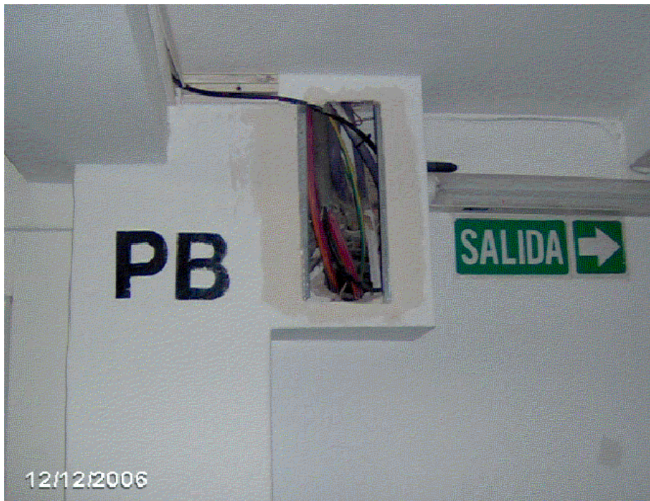
Foto N° 13 – En planta baja, en la salida de vehículos sobre Berutti se puede observar una caja de derivación eléctrica sin tapa con cables expuestos.
