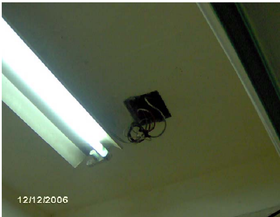
Foto N° 7 – En el cielorraso del sector de Mantenimiento Barrial se puede observar una boca de electricidad con cables expuestos encintados que alimentan a un artefacto de iluminación.
