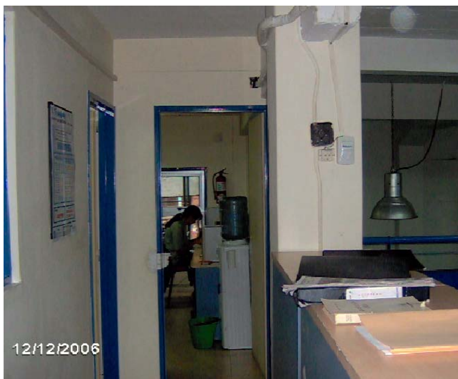
Foto N° 9 – En la presente vista se puede apreciar una caja de derivación eléctrica embutida y sin tapa, la que presenta conductores expuestos.
