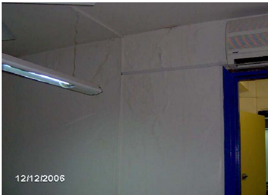
Foto N° 8 – En una pared de la oficina se pueden observar los efectos de una filtración de un tanque de agua del piso superior.
