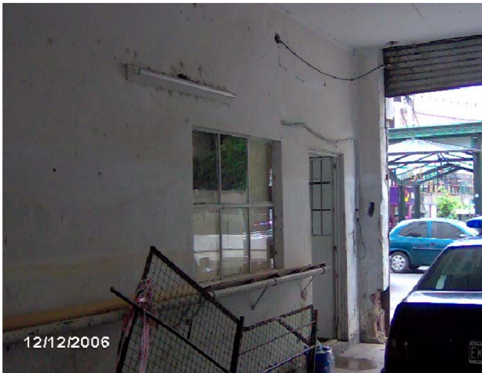
Foto N° 17 – En la presente vista se puede apreciar el mismo sector de la foto anterior en la parte de salida de vehículos donde se pueden observar cables expuestos, las paredes con deterioros y cajas de electricidad sin tapas.
